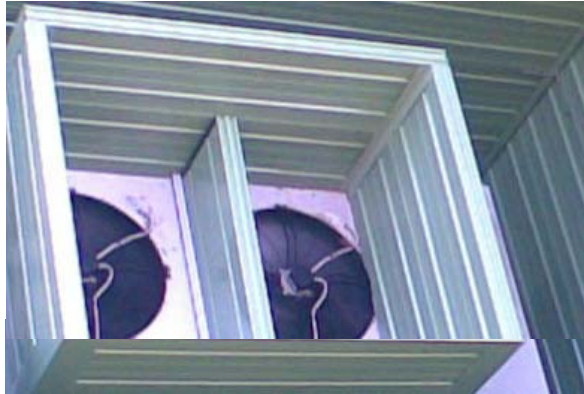
Fig. 7 – Schema di realizzazione del plenum sopra la pompa di calore condominiale.
